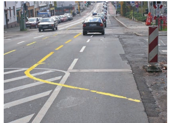
Bild 1: Nach Teilabschluss der Kanalbauarbeiten wurde die Markierung und ein Teil der Verkehrssicherung nicht entfernt. Der Unternehmer haftet in vollem Umfang weiter
