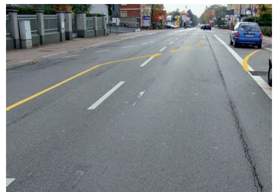
Bild 2: Die Baustelle wurde völlig geräumt, aber die Markierung nicht entfernt. Die Verkehrssicherung liegt automatisch wieder bei der zuständigen Straßenbaubehörde
