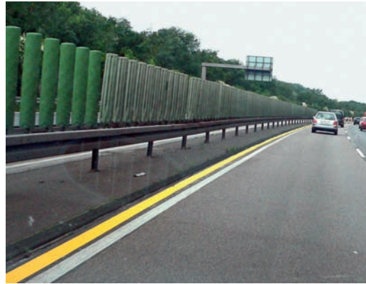
Bild 4: Die Baustelle wurde völlig geräumt, aber die Markierung nicht entfernt. Nach StVO wird dadurch die weiße Randmarkierung aufgehoben, was in diesem Fall zwar unproblematisch ist, aber für die gelbe Markierung existiert keine Genehmigung mehr
