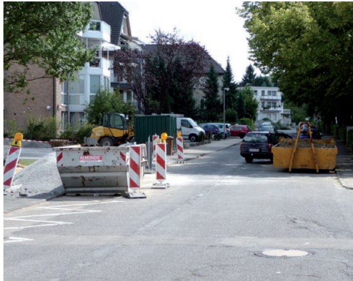
Bild 1: Mangelhafte Verkehrssicherung im Bereich der Fahrbahn (ungeschützter Container) und des Gehwegs (falsche und unzureichende Absicherung)
