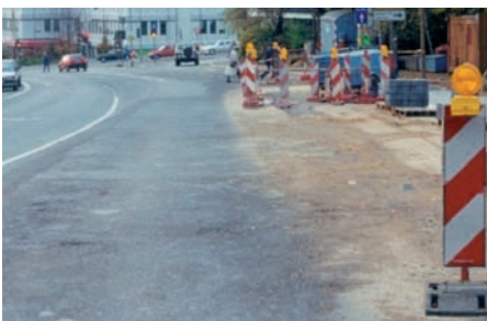
Bild 8: Fehlende Verkehrsführung infolge fehlender Leitbaken
