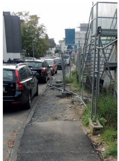
Bild 30: Fehlende Kennzeichnung einer Gehwegsperrung
