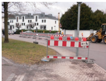
Bild 26: Sperrung eines Gehwegs mit fehlendem Verkehrszeichen und falscher Nutzung des Zusatzzeichens
