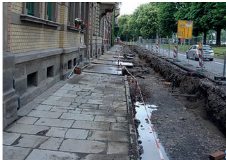
Bild 3: Mangelhafte Verkehrssicherung im Bereich eines Gehwegs [Korsch]
