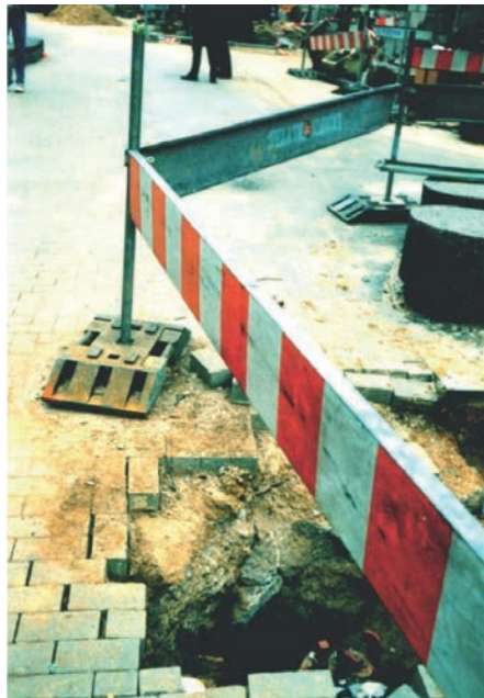
Bild 4: Mangelhafte Sicherung einer Baugrube
