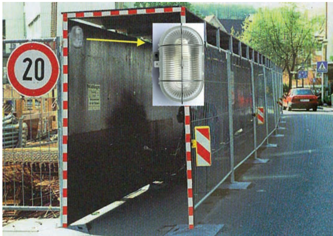
Bild 7: Fußgängertunnel gemäß ZTV-SA mit Warnleuchte WL9 ausgerüstet
