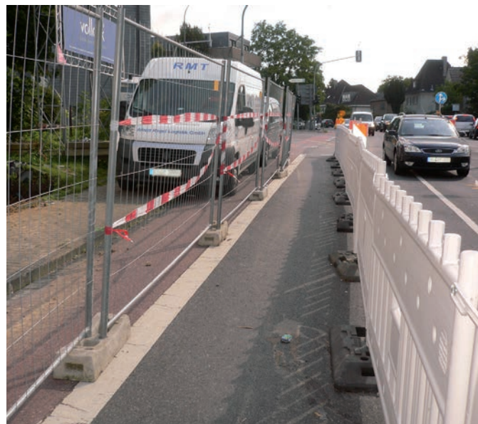
Bild 4: Kennzeichnung mit Warnband ist unzulässig
