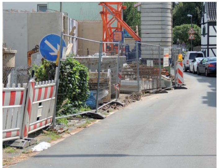
Bild 2: Bauzaun ohne Absperrkennzeichnung im Sinne der StVO
