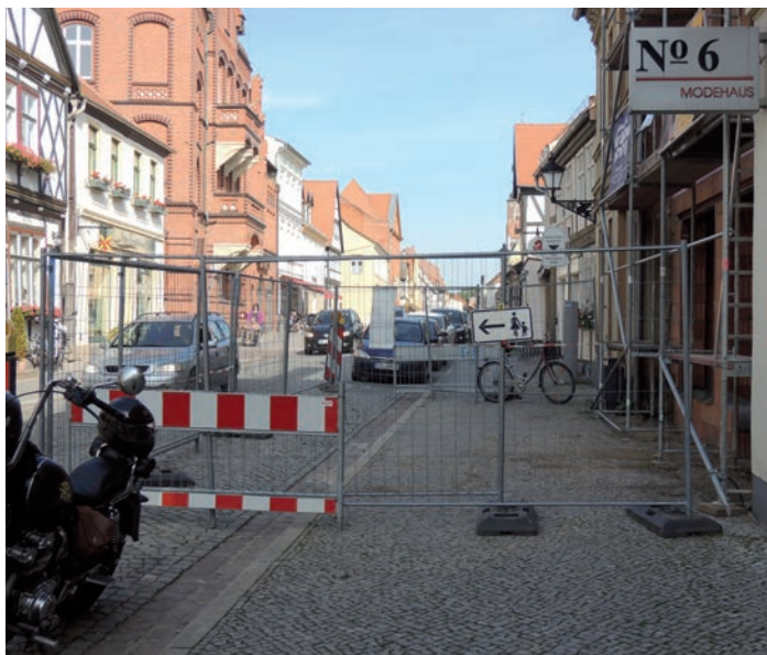
Bild 3: Fehlende Kennzeichnung im Fußgängerbereich (s. auch 1 )
