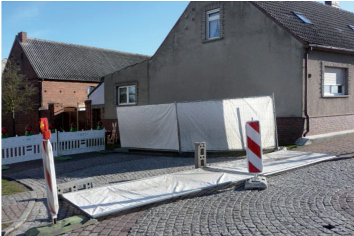
Bild 6: Mangelnde Standsicherheit eines Bauzauns mit Sichtschutz (Bild Hoffmann)
