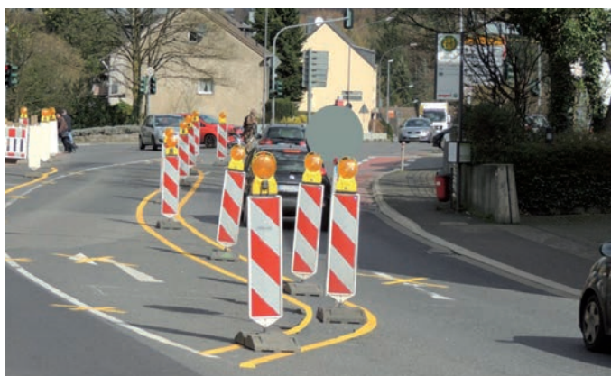
Bild 8: Durch Leitbaken abgesicherte Insel zwischen entgegengesetzt gerichteten Verkehrsströmen
